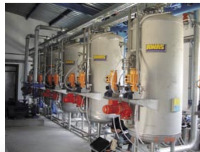
Saturatoren mit Chemiedosierung
