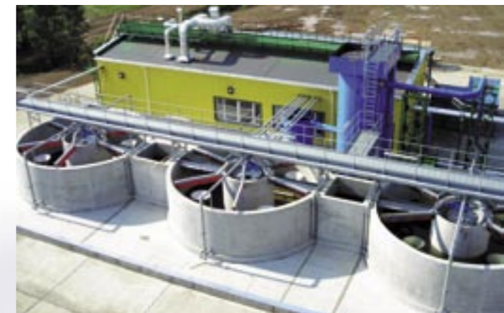
Комплексные очистные сооружения AWAS
